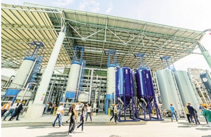
L'impianto di biometano a Montello
